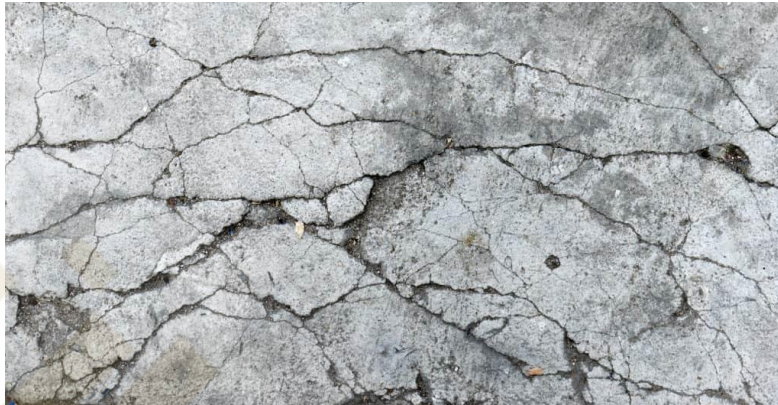
شکل ۳ ترک خوردگی بتن
