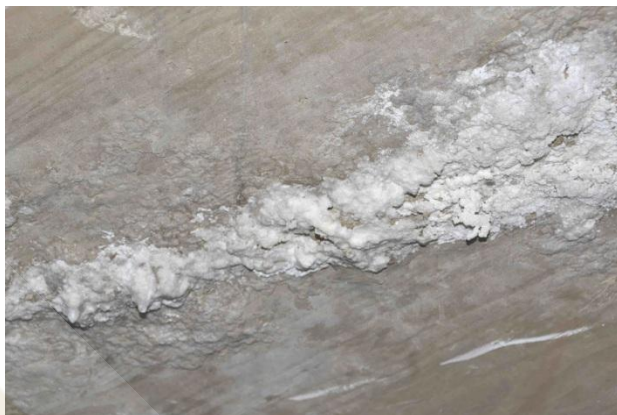
شکل ۴ فرسایش سطوح بتنی
