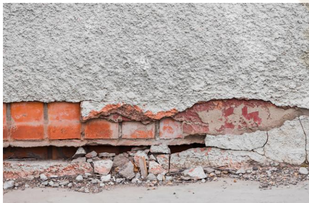
شکل ۵ فرسایش سطوح بتنی
